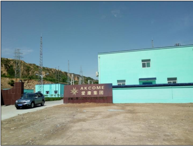
太子公司 110kV 升压站
