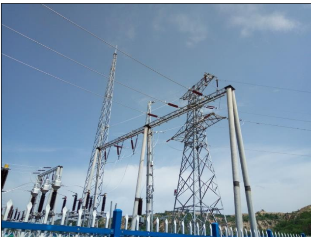
太子公司 110kV 升压站出线
