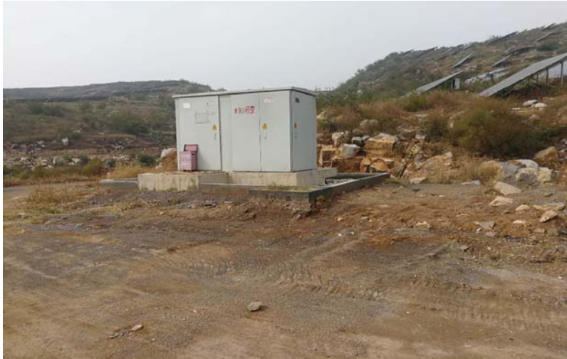
箱变逆变平整
