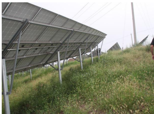
光伏板基础下方绿化
