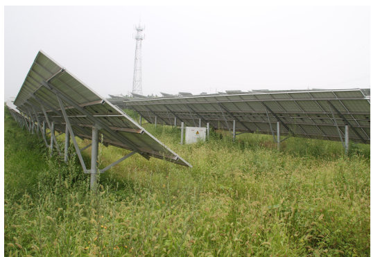
光伏组件区绿化
