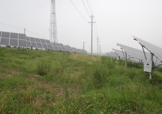
光伏组件区绿化
