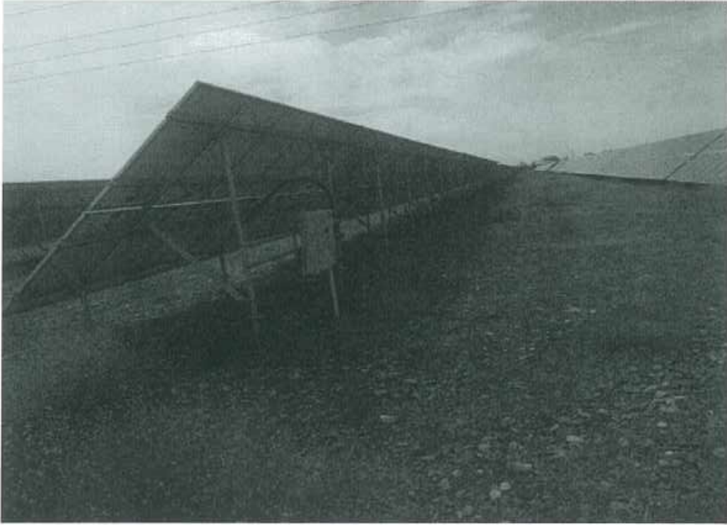
图 1-5-3 已实施完成的光伏组件支架
